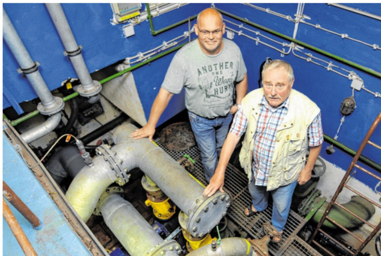
Schwimmeister und Betriebsleiter Holger Rissel (l.) und Friedhelm Werthmann vom Förderverein Voerder Bäder in der „Herzkammer“ des Freibades, dem Pumpenhaus.
